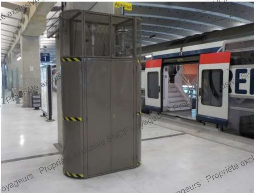
Photographie 4 : Emplacement de la baie de mesure sur le quai B
