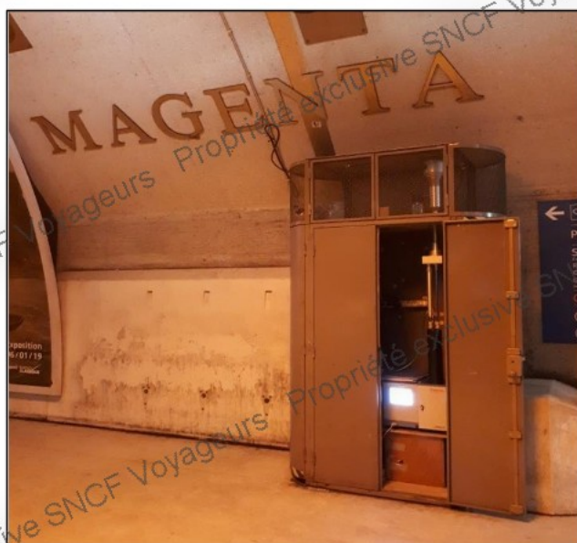
Figure 1 – Baie de mesure en gare de Magenta et visuel sur l'analyseur automatique de particules (TEOM)
